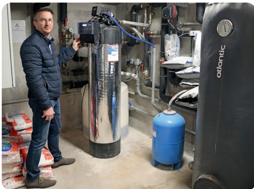
La maintenance des équipements, une priorité.
